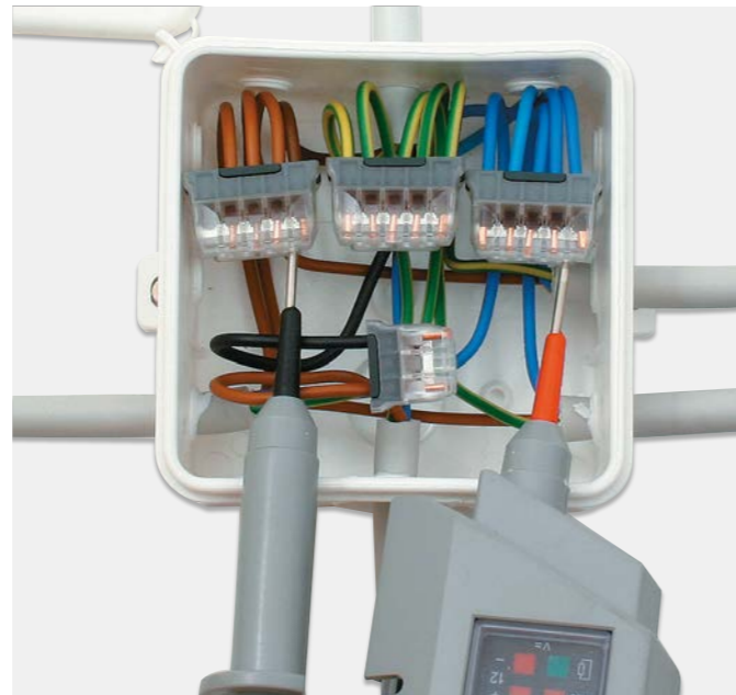
Prüfen in Aufputzverteilerdose mit Prüfstift Ø 2 mm Using a test probe 2 mm Ø in a surface-mounted junction box
